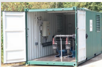
Автономная насосная станция
