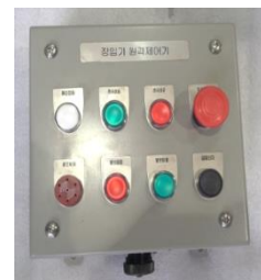
УДАЛЕННАЯ ПАНЕЛЬ УПРАВЛЕНИЯ
